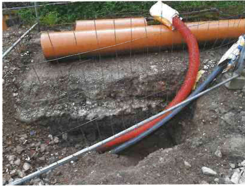
Photo 1 (conduite de refoulement + gaine tire-câble)
