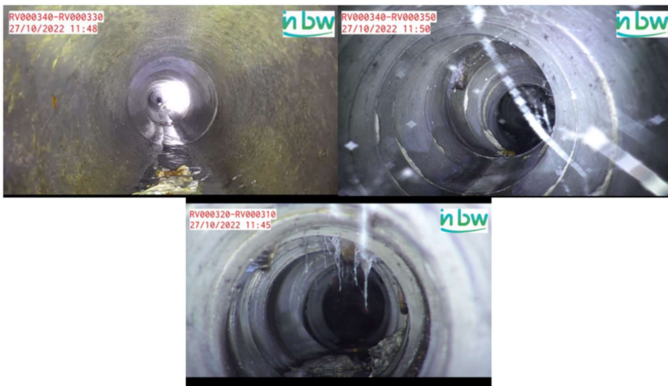
Figure 3 : tronçon rue de la station – confirmation visuelle de présence d'eau usée domestique
