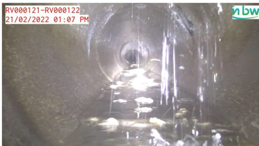
Figure 4 : tronçon rue du Gros Chêne – confirmation visuelle de présence d'eau usée domestique
